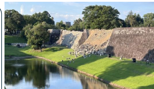
熊本城 石垣崩落
