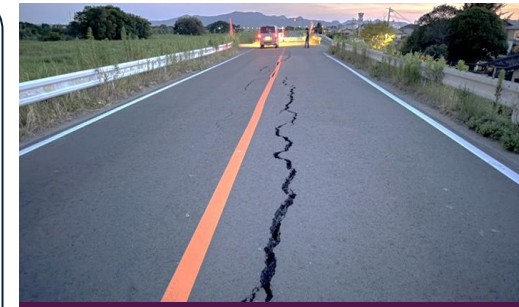
道路のひび割れ
