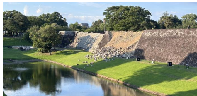
熊本城 石垣崩落
