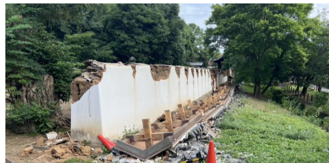
北岡自然公園の築地塀崩壊
