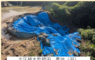
北区植木町鈴田 農地(田) 法面崩壊 L=10.0m
