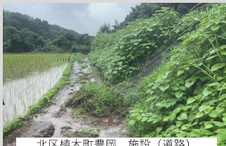
北区植木町豊岡 施設(道路) 法面崩壊 L=4.0m
