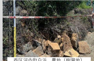
西区河内町白浜 農地(樹園地) 石積崩壊 L=5.0m
