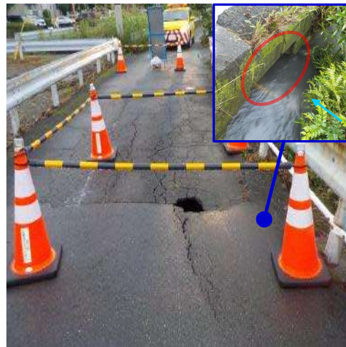
石積欠落・市道陥没:藻器堀川(東区)
