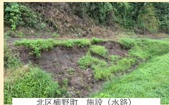
北区楠野町 施設(水路) 法面崩壊、水路閉塞 L=15.0m
