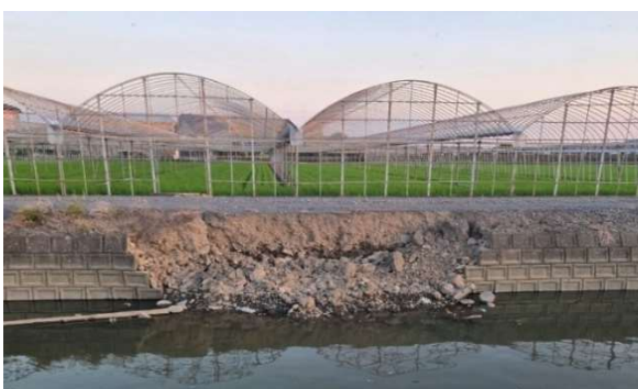
水路護岸の破損
