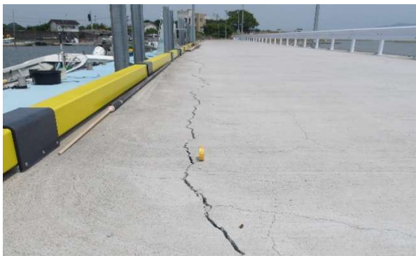
漁港の舗装のひび割れ
