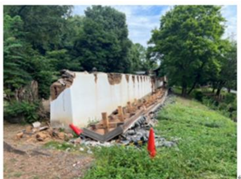
塀屋根部分の崩落
