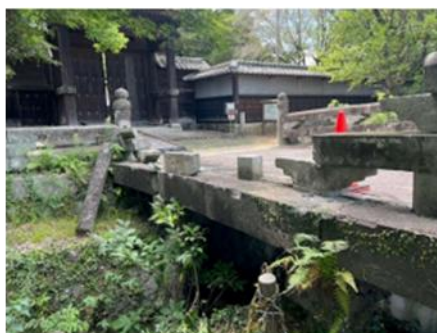
石橋欄干の落下
