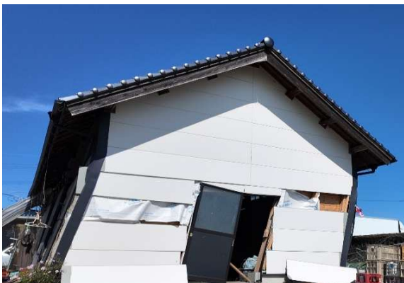
農業用倉庫の倒壊
