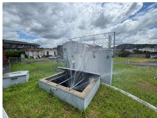
【水道】北区清水亀井町(亀井4井)
