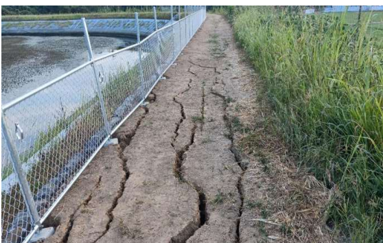
ため池の堤体のひび割れ
