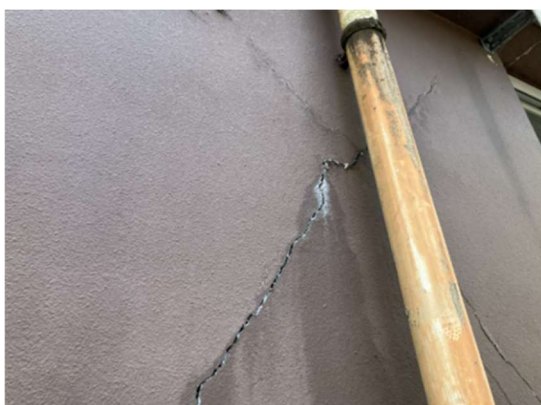
城東小学校 外壁の損傷
