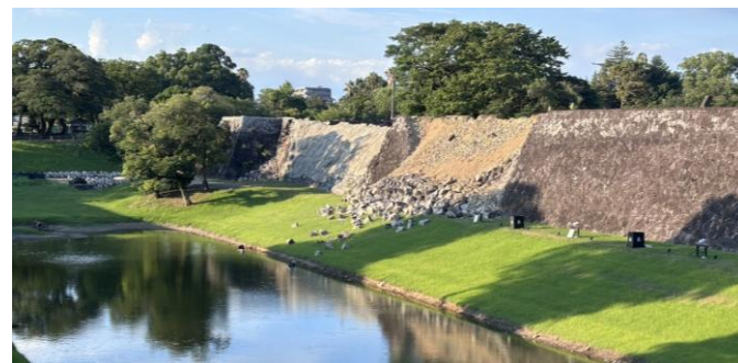
熊本城 石垣崩落
