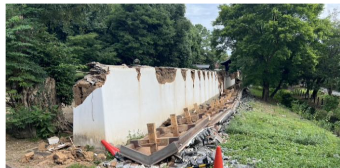
北岡自然公園の築地塀崩壊
