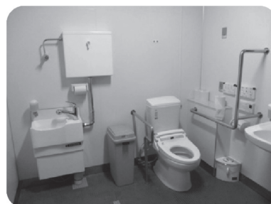
多目的トイレ (熊本市役所内)
