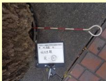
②植栽基盤の不良
