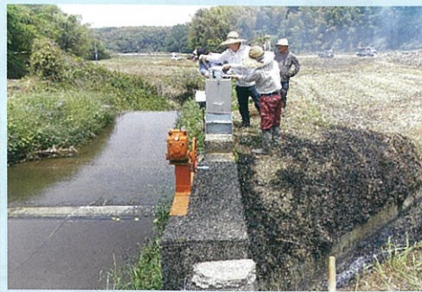
自動転倒ゲートの機能診断
