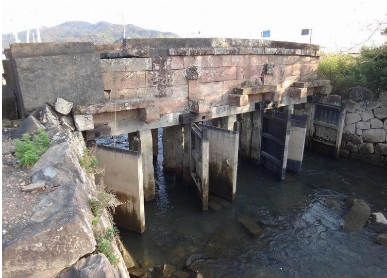
崩壊前の井樋堰
